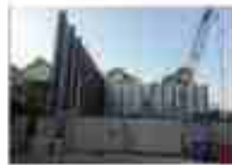
TEMPORARY NB(FENCE) 가설 방음판
